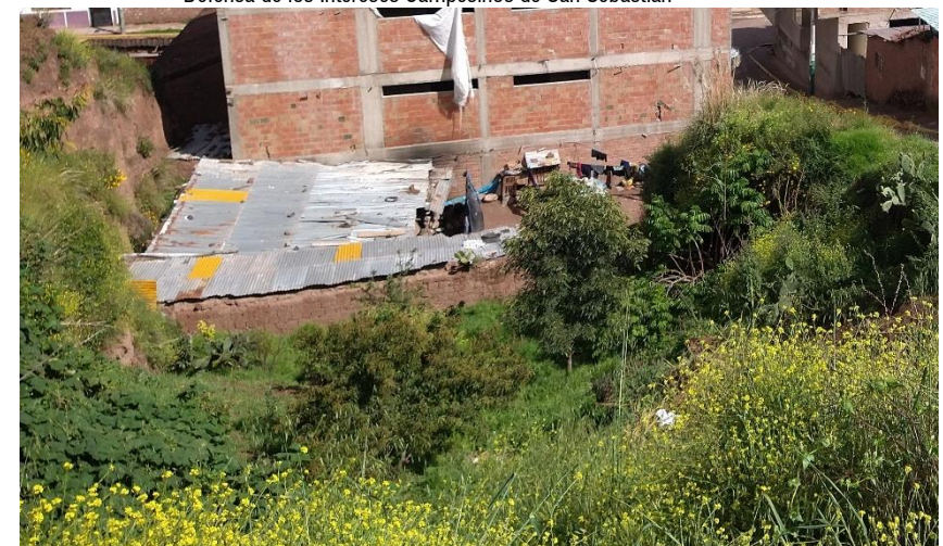
Imagen N° 72: Edificación en muy mal estado de conservación de la APV. Frente de Defensa de los Intereses Campesinos de San Sebastián
